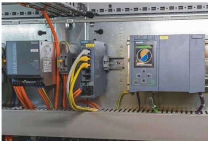
Bild 5: Die Security Appliance SCALANCE S615, der Controller SIMATIC S7-1500 und das Netzteil SITOP PSU8200 sind Komponenten, die im Schaltschrank bei Festo installiert sind.
